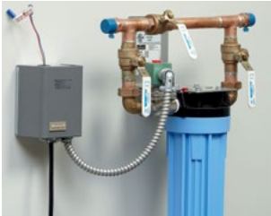
Systèmes de filtration/dérivation d'eau Assurent une coupure sécurisée de l'alimentation en eau depuis le cabinet dentaire.
